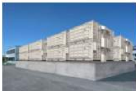
サーラ浜松蓄電所
